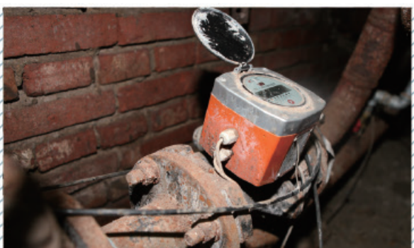
北京住建部办公区供热计量项目
