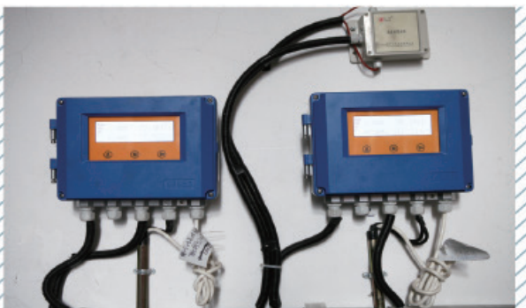
渝中热力换热站热计量项目
